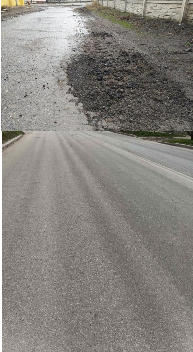
Рисунок 3 – Дефекти асфальтобетонного покриття, спричинені рухом гусеничної військової техніки
