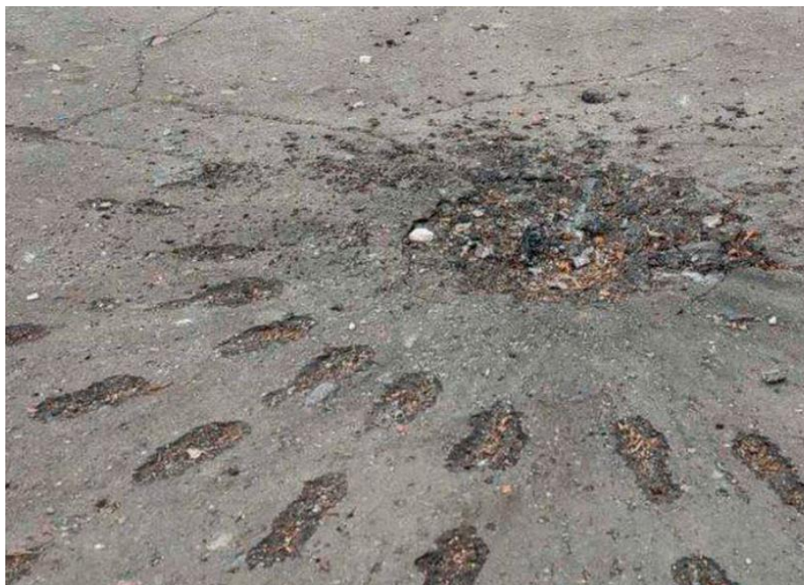
Рисунок 1 – Вигляд асфальтобетонного покриття у місці прильоту касетного снаряда з системи РСЗВ [1]
