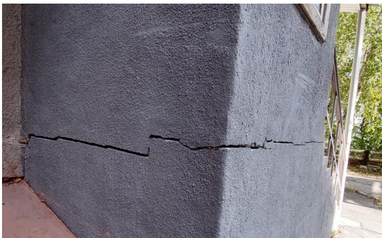
Рис. 4. Сліди руйнування на добудованих сходишках на південній стороні гуртожитку
