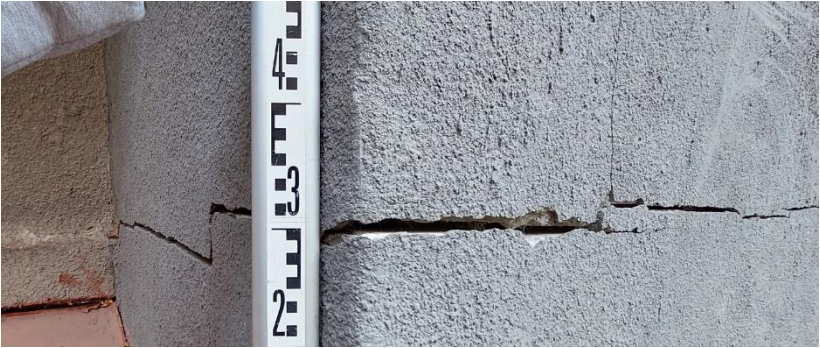
Рис. 5. Деталізація руйнування на добудованих сходах
