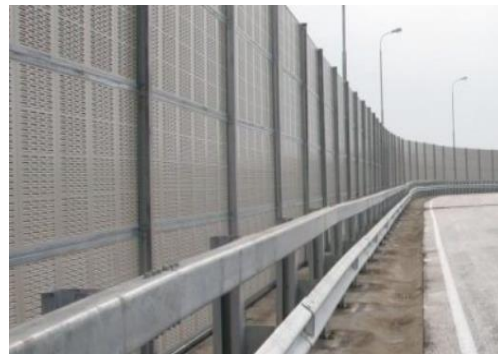
Рис. 2. Металевий шумозахисний екран
