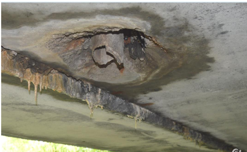
Рисунок 4 – Зміщення суміжних плитних блоків на 10 см и руйнування водовідвідної трубки і плити поряд з нею
