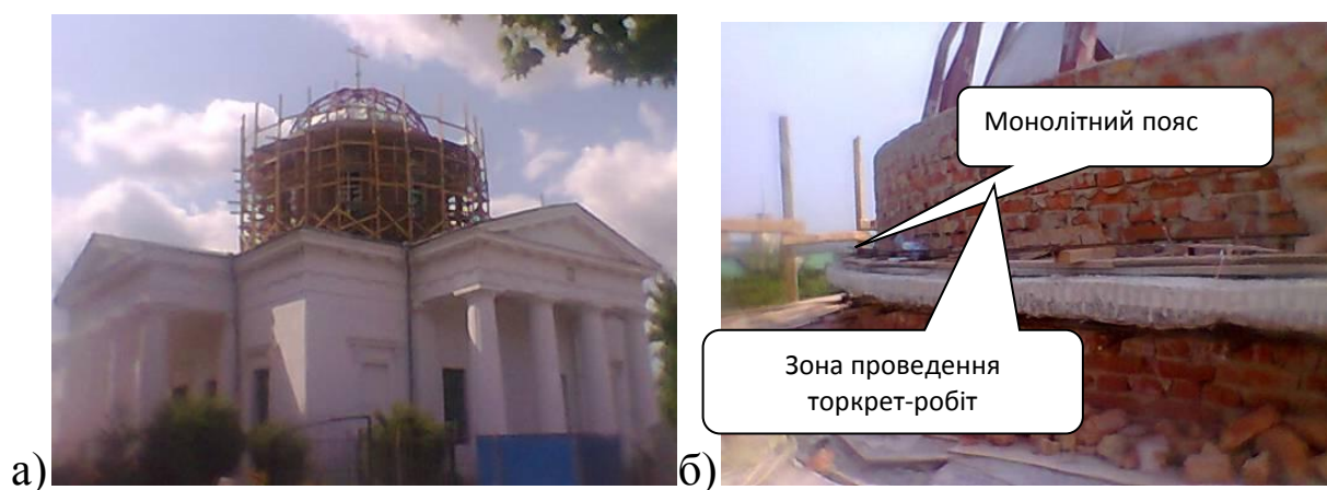
Рис. 3. Реконструкція Свято-Покровського собору в м. Чугуєві: а – конструкція купола; б – місце підсилення монолітного поясу
